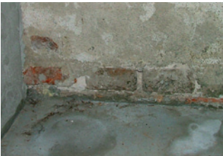
Feuchteschäden im Keller
